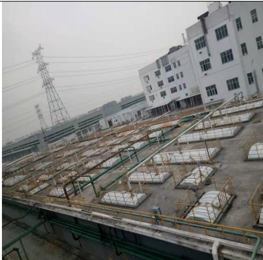
废水处理设施--收集池+调节+A/O
